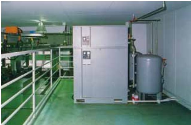
＜設置例＞中2階に設備したパッケージコンプレッサーと補助タンク (注：現モデルとは異なります)
